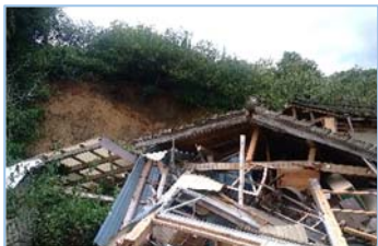
土砂崩れで全壊した家屋
